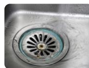
排水管、排水溝から の臭い
